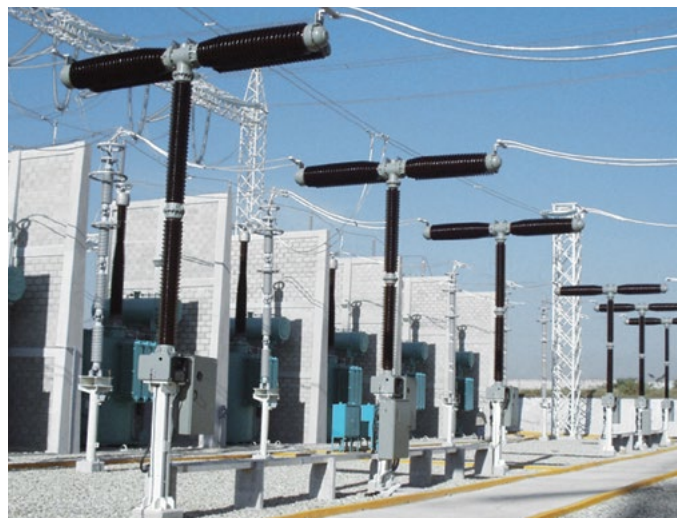
ЗАР2 FI 420 kV
